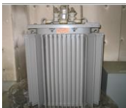
高圧トランス（変圧器）
